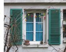
Fenêtres pvc doubles vitrages remplacées par fenêtre bois triples vitrages avec croisillons et grille hygro-réglable
